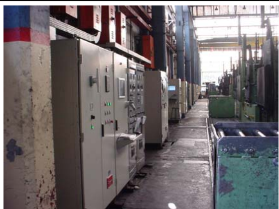
Fig. 62 - Quadro de distribuição de energia em indústria -1
