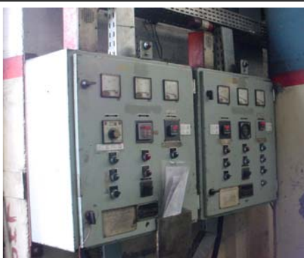
Fig. 64 - Quadro de distribuição de energia elétrica em indústria -2
