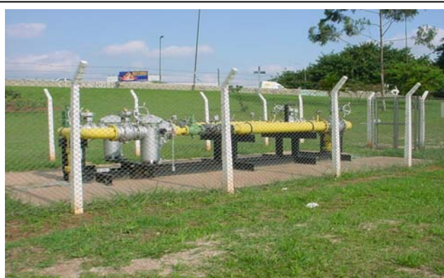
Fig.45 – Conjunto de redução de pressão e medição de gás natural
