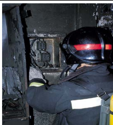
Fig. 63 - Quadro de energia atingido por incêndio
