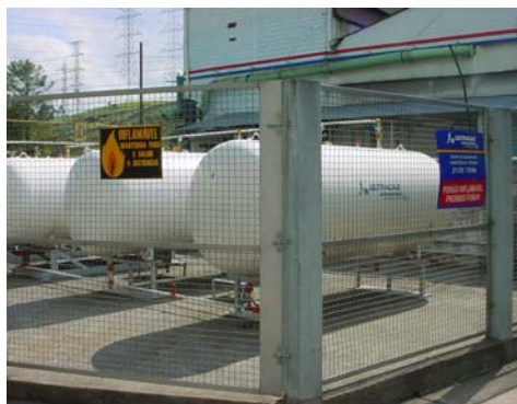
Fig.43 – Grandes Reservatórios de GLP em indústria - 1
