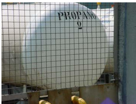
Fig. 44 – Grandes Reservatórios de GLP em indústria -2
